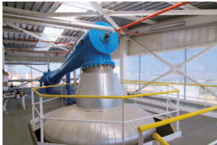
Parte superior columna destilación ácidos grasos. Conexión a eyector de unidad de vacío
