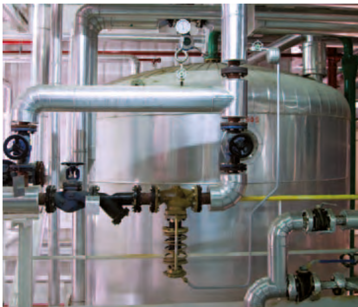
Colector General de Vapor
