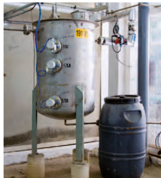
Depósito de Ácido Sulfúrico
