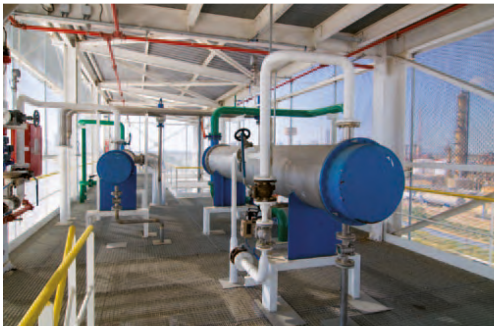
Condesadores de las Columnas de Destilación
